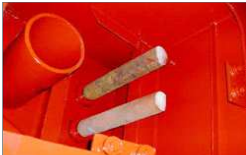
Figura 3. Ánodos de Cobre y Hierro en Caja de Mar.
